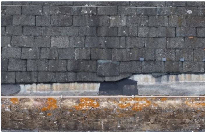
D01-A — Slipped Tiles / Slates, Perimeter / Edge
